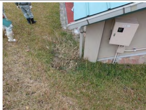
[6] 雨水で削られた建物角部の斜面を見る
