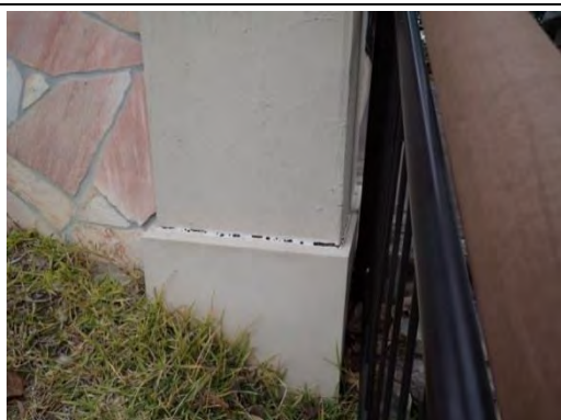
[8] 覆屋上段柱部根もとの外壁材に浮が見られる
