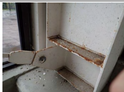
[7] 屋内の鉄部全面に錆が確認できる
