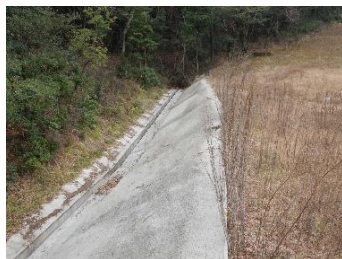
写真 2-47 敷地北側の排水側溝
